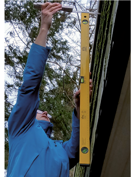
An der Friedhofskapelle in Brelingen hat der Sturm das Dach verschoben.
